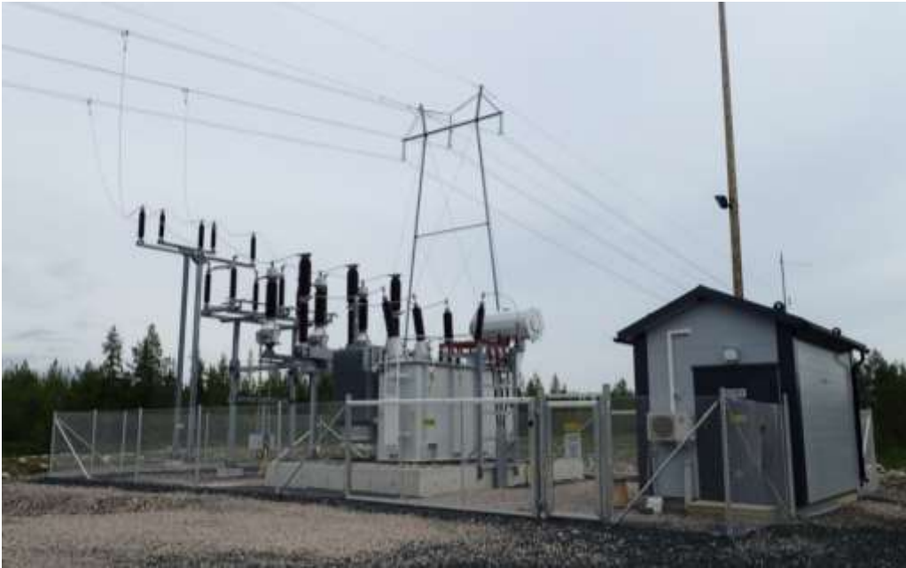
Kuva 80. Esimerkki tuulivoimahankkeen sähköasemasta (Minna Takalo, FCG).
