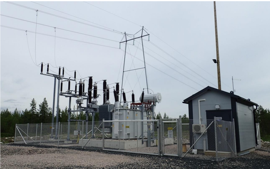
Kuva 5.7. Esimerkki tuulivoimapuiston sähköasemasta. (Kuva: Minna Takalo / FCG).
