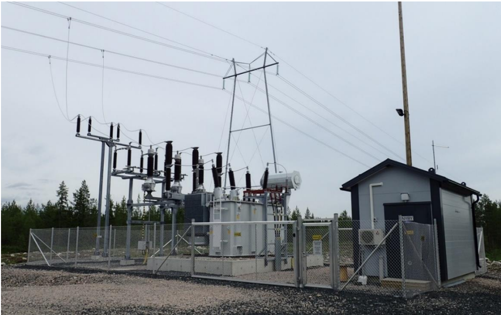
Kuva 85. Esimerkki tuulivoimahankkeen sähköasemasta (Minna Takalo, FCG).
