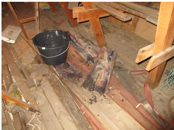
Skadade brädor och isolering vid läckage
