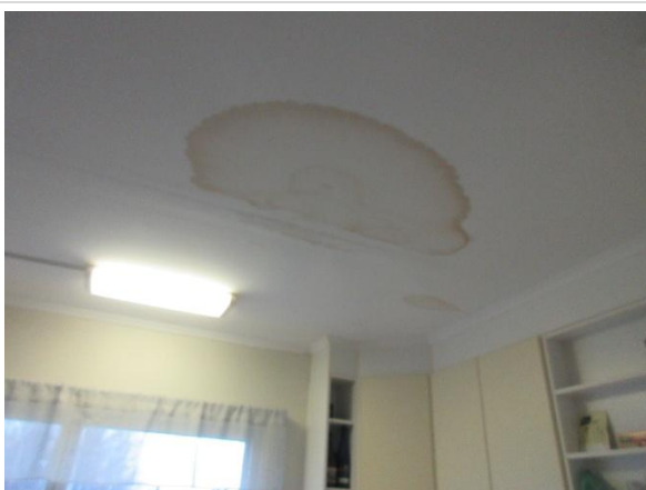
Skadat innertak i köket i lägenhet 2
