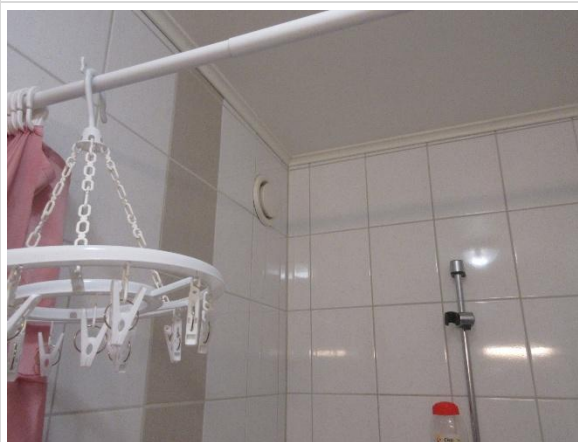
Frånluftsventil i badrum i lägenhet 3
