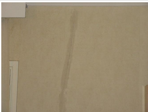
Spricka i tapeten på yttervägg
