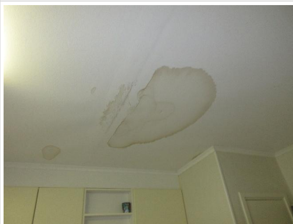
Skadat innertak i köket i lägenhet 2
