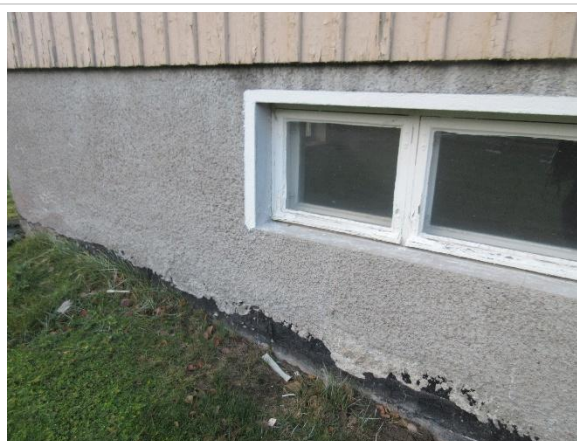
Synligt bitumen strykning på källarvägg
