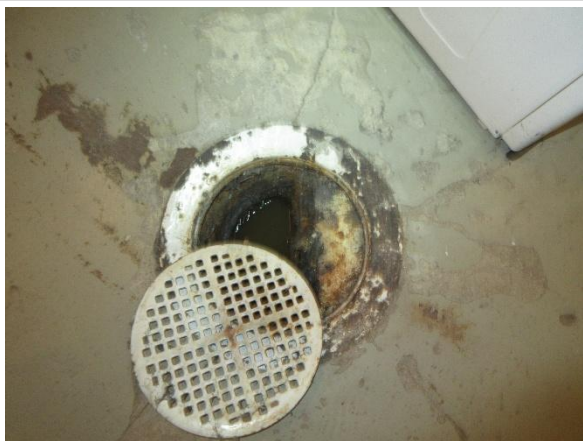
Golvbrunn i gjutjärn i källare
