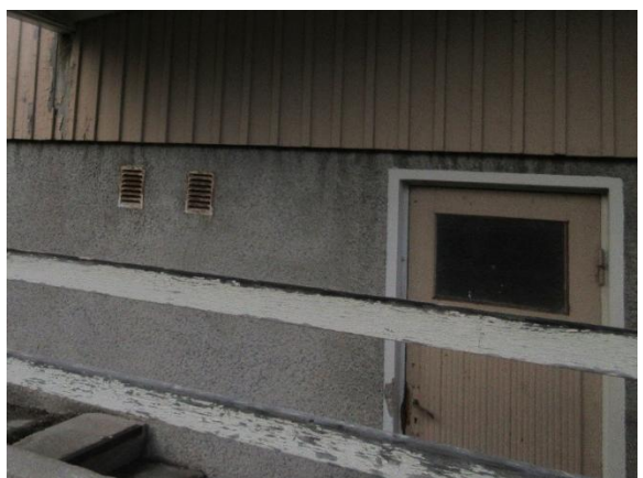
Ytterdörr till omklädningsrum i dåligt skick
