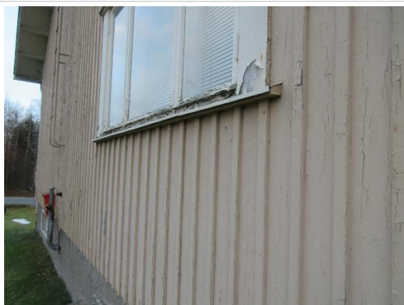
Målfärg flagnar på fönsterbrädor
