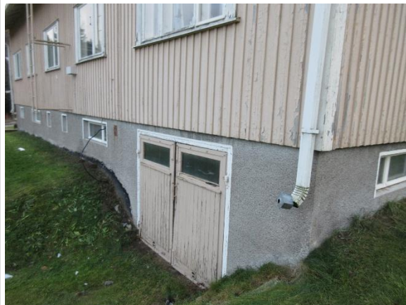
Garagedörrar ursprungliga i dåligt skick
