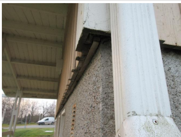
Saknar fungerande luftspalt bakom panelen
