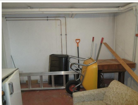
Värmerör med misstänkt asbest isolering i innertak i källare
