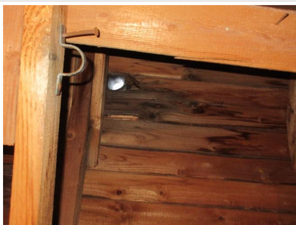
Kallvind öppen genomföring i taket
