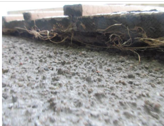
Saknar fungerande luftspalt bakom panelen
