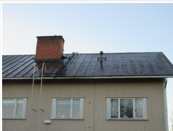
Skorstenen saknar regnhatt samt ny takgenomföring intill
