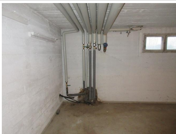
Värmerör till intilliggande skolfastighet
