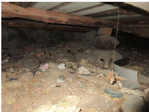
Skräp på markytan i krypgrundsutrymmet
