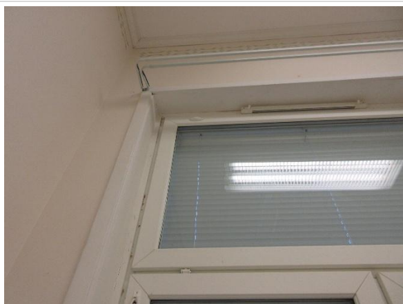
Friskluftsventil i fönsterkarm
