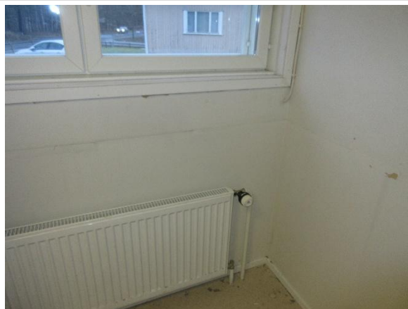
Värmerör av svartstål, radiator förnyad
