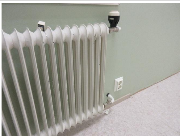
Äldre värmeradiator med förnyad termostat
