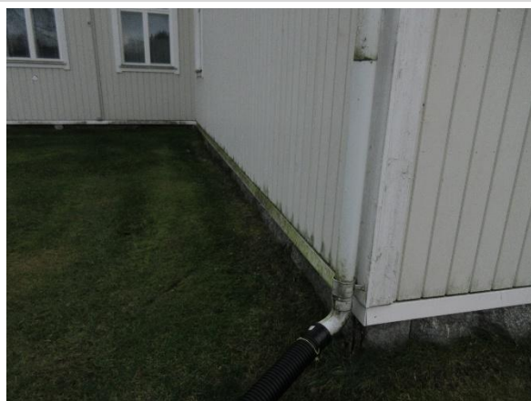
Algväxtlighet på fasaden mot norr
