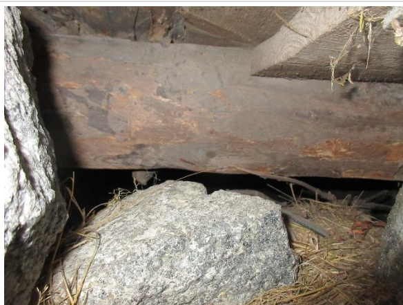
Vid vissa ventilationshål var sikten skymd
