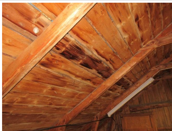
Spår av gammalt läckage på takbrädor
