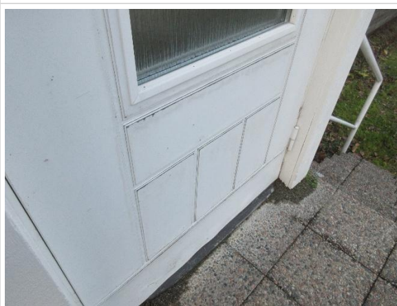
Lite slitage på ytterdörrens målfärg utvändigt
