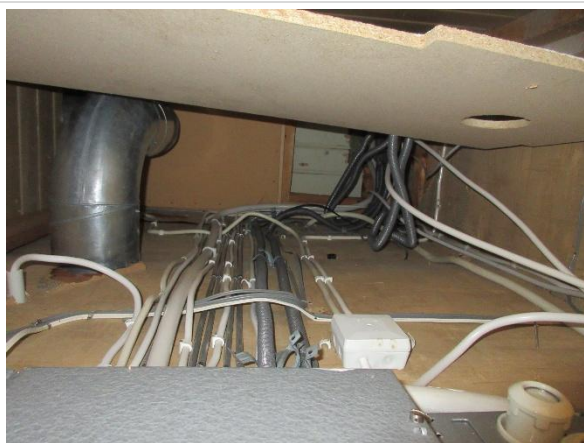
El-dragningar i en skrubb i ett klassrum
