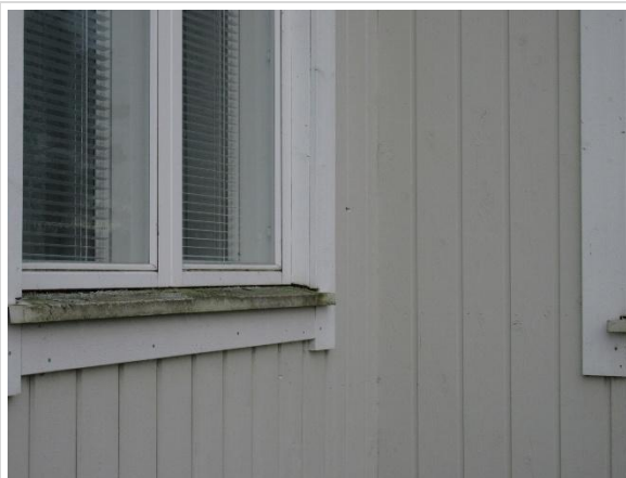
Mossa och algväxtlighet på fönsterbleck
