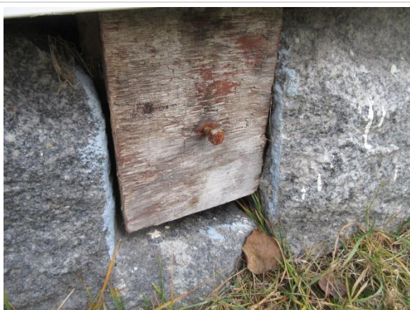
Igentäppt ventilationshål i stenfoten
