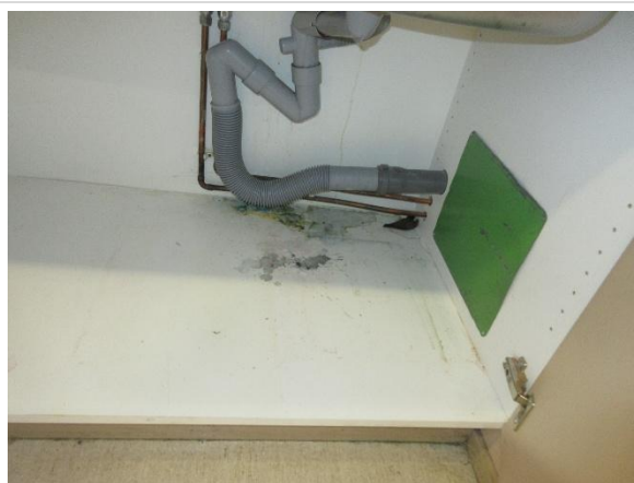
Bruksvatten i koppar under diskbänk i klassrum
