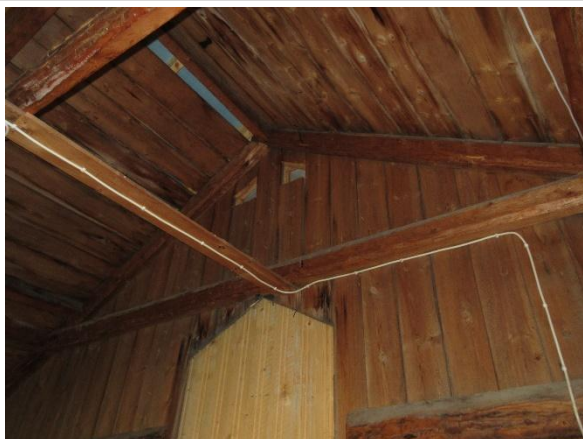
Gavelvägg med ventiler
